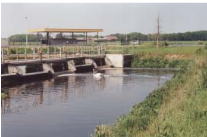
AFBEELDING 1.3 KANTELSTUWEN VOOR AFLAAT VAN PIEKEN IN EFFLUENT NAAR DE MAAS
